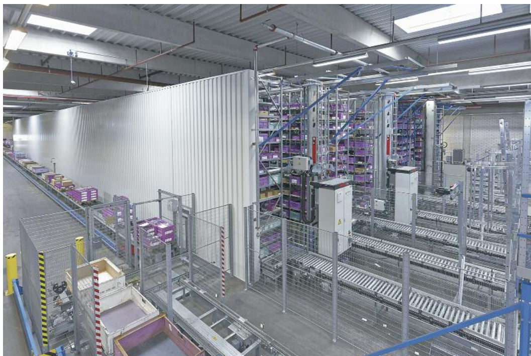
Die von Aberle eingesetzte SPS CPU 315F steuert die fünf RBGs exakt und energieeffizient. Das bei laufendem Betrieb um zwei Gassen erweiterte AKL bietet 27 000 Tablarstellplätze
